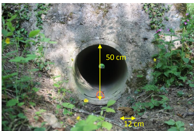
Figure 23 Caractéristiques de la buse béton du secteur 3 de la RD7: 11 m de longueur, 50 cm de diamètre. Un crapaud commun de 12 cm est représenté. ©DB
